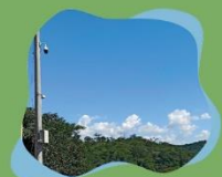
Sistema instalado no Canal de Fuga
