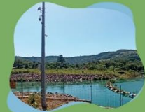
Sistema instalado no canal de adução
